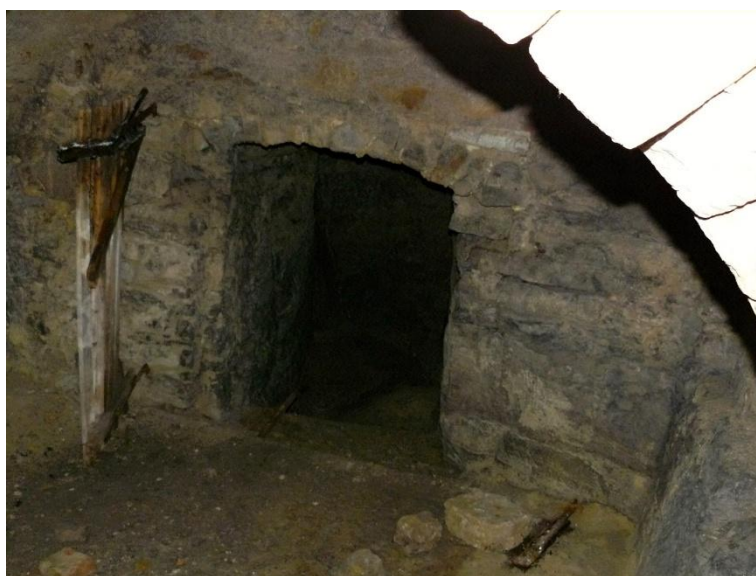
Obr. 12. Prostřední zaklenutá sklepní prostora pod destruovanou obytnou budovou čp. 67 v pohledu ze schodiště. Foto autor
